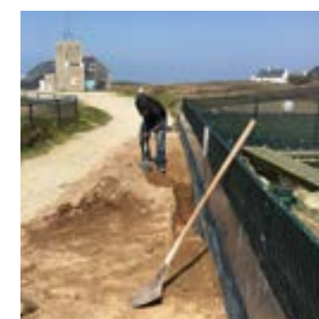
Travaux en grande volière : creusement de l'une des tranchées périphériques permettant d'enterrer du grillage pour interdire l'accès aux rats.
