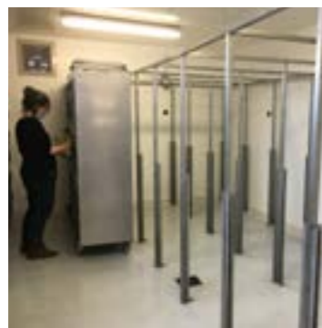
Le portique est terminé ! Ne manquent plus que les plaques PVC permettant d'individualiser les différents box de soins.
